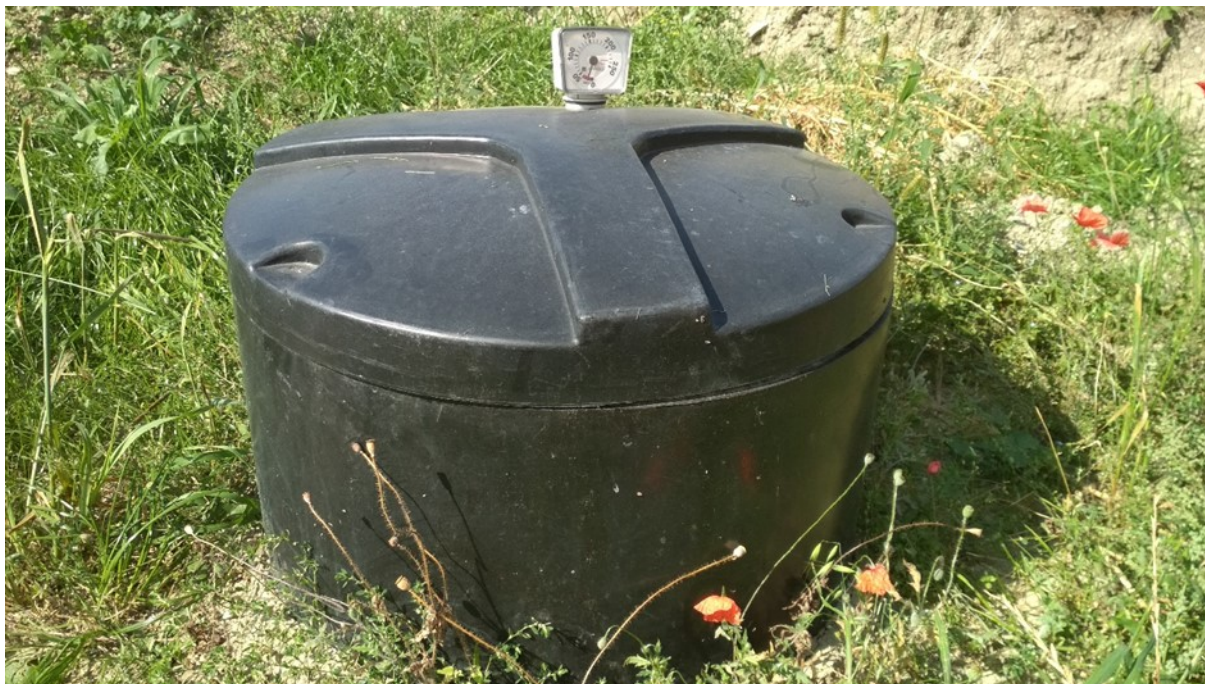
Obrázek 1 - Podzemní nádrž na podzemní vodu
